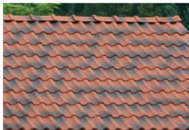
A éviter : les tuiles artificiellement panachées.
